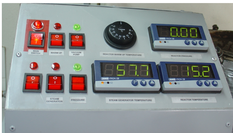
Εικόνα 19: Ο πίνακας ελέγχου της πιλοτικής διάταξης ανάκτησης πρώτων υλών ξυλοπλακών
